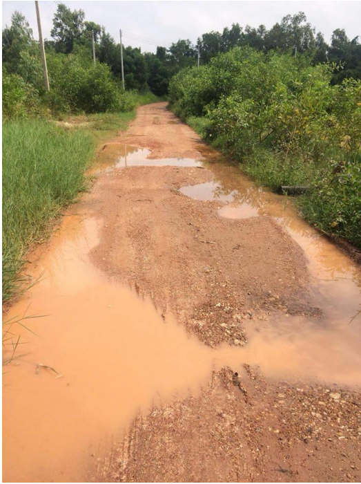
๒๙. โครงการถนนลูกรัง เลียบหนองโพรง หมู่ที่ ๒ ตำบลบางคา วันที่ ๑๘ กันยายน ๒๕๖๑
